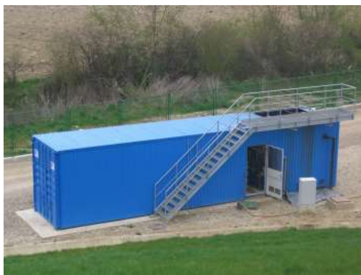
Slika 1.2./5. Pogled na uređaj za pročišćavanje procjednih voda iz odlagališta
